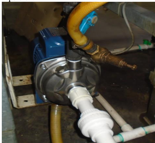
Figura 10. Nueva bomba del sistema de aspersión.
