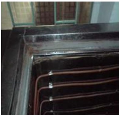
Figura 26. Martínez Mesa, M. Fotografía equipos de refrigeración en mal estado (2012).
