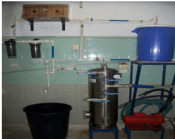
Figura 7. Ruiz Bernal, J. Fotografía identificación de las tuberías (2013).
