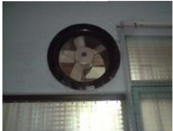
Figura 4. Ruiz Bernal, J. Fotografía del extractor sin protección contra insectos y plagas (2012).
